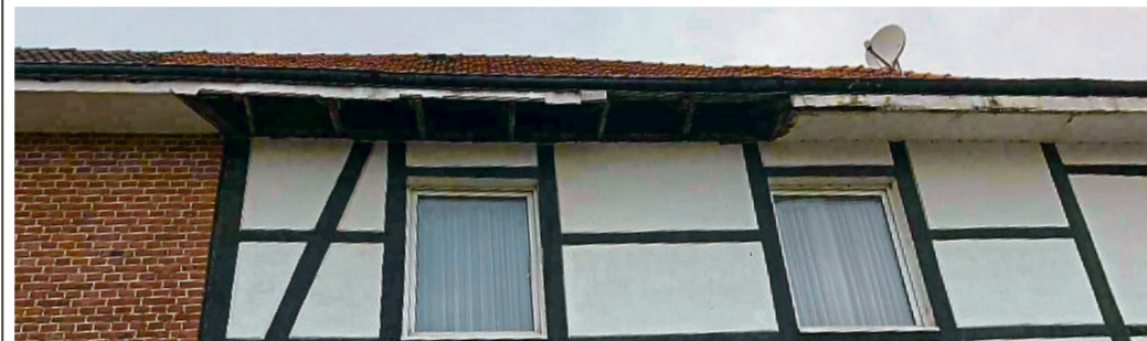
Weiße Abdeckplatten vom Dachsim flogen am Mittwochmorgen vom alten Brennereigebäude Hasselmann herunter. Die Feuerwehr rückte aus. Foto: Christian Wolff
